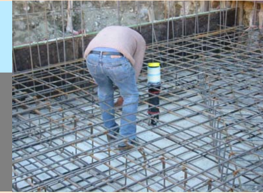
PP2 “Stagnazione degli elementi passanti la platea”
