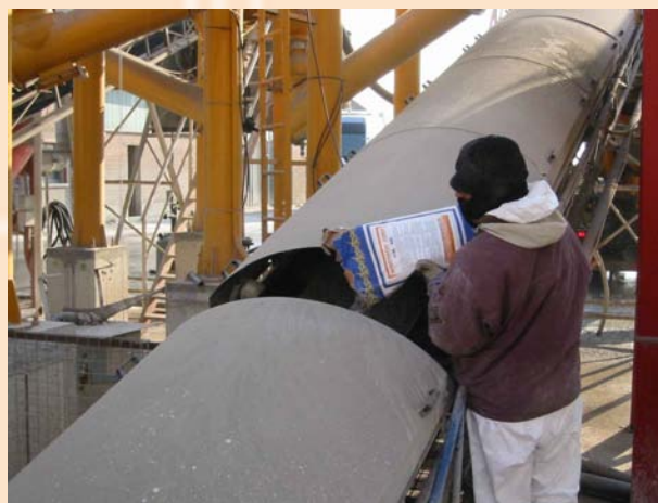
Miscelazione a secco sul carrello degli inerti
