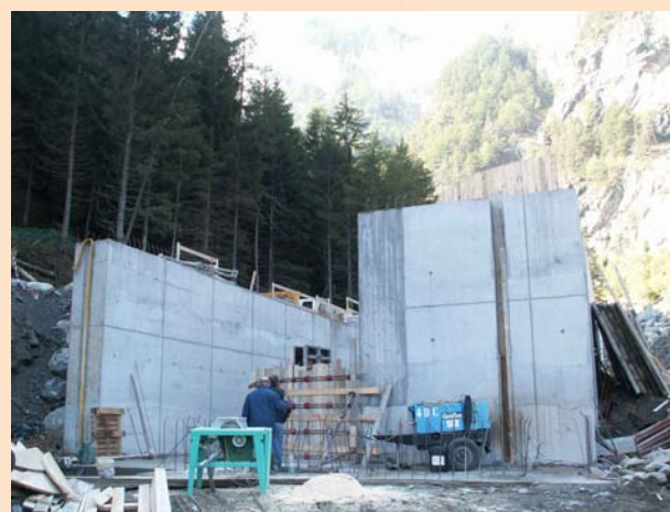
Opere di presa in quota
