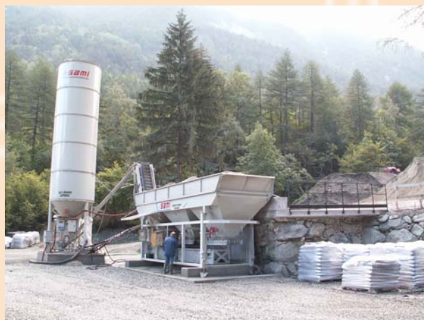
Centralina di betonaggio di cantiere
