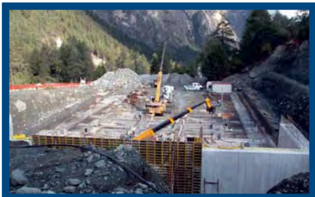
Impianto Idroelettrico "Clavaltè", Fenis, AO - (2006)
